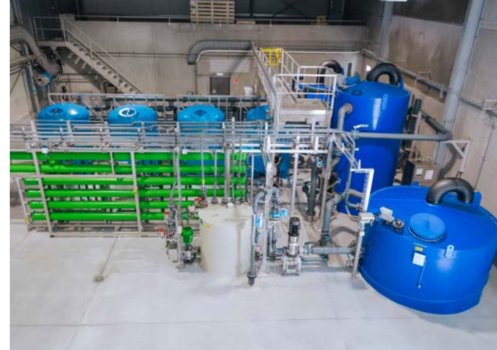
Das System bei VEOS zur Wasseraufbereitung und Rückgewinnung von Energie aus dem gereinigten Wasser.
